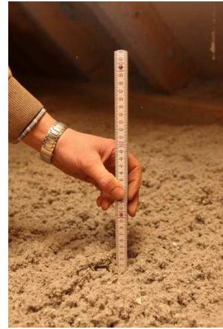
Gut gedämmtes Dach: 32 Zentimeter stark ist die offen aufgeblasene Papiercelluloseschicht.
