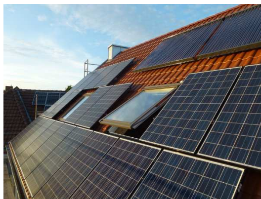
Eine Photovoltaik- und Solarthermieanlage mit Südausrichtung konnte auf dem erneuerten Dach installiert werden.
